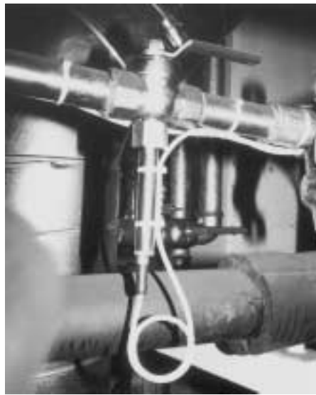
3: Typische Messstelle in einer Stichleitung
